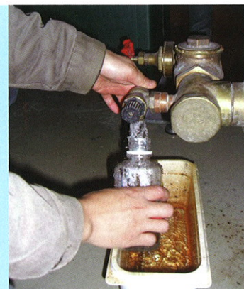
BEREDER: Vannprøve tas fra bereder.
